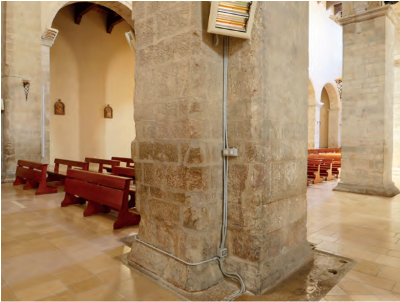
Abb. 2. Kathedrale von Acerenza: Brandspuren an den westlichen Vierungspfeilern, von Nordosten.
